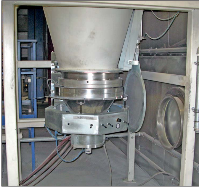
Der mit einem „PMC“ ausgestattete Zyklon wird über spezielle „DDF“-Förderschläuche mit dem Pumpenrack und der Frischpulverförderung verbunden.
