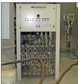
Das Rack zwischen Zyklon und Pulverförderungen umfasst die DDF-Pumpen.
